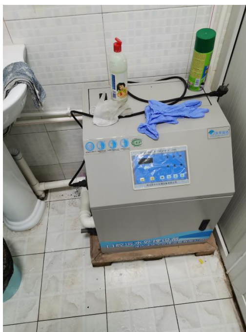
医疗废水处理设施照片
