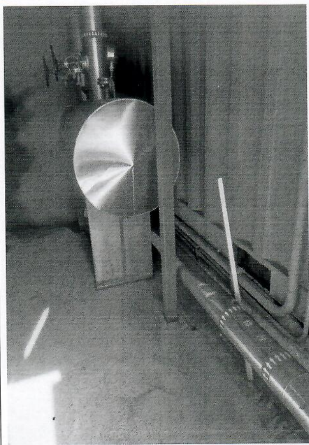
锅炉排污水管道
