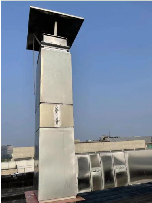
图 7 楼顶废气排放口
